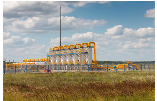
Gasspeicheranlagen müssen gegen Leckagen gesichert sein.
